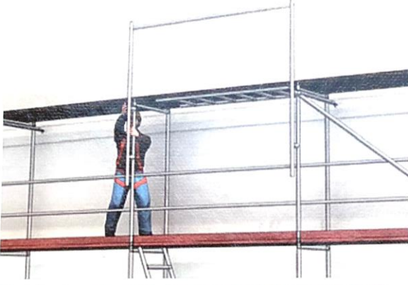
Güvenli çalışma önce toplu koruma önlemleri alınarak sağlanır.
